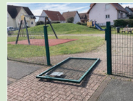
Portail du terrain de jeux arraché
